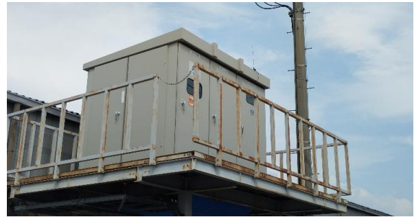
④ 本社工場・共同工場 キュービクル点検
